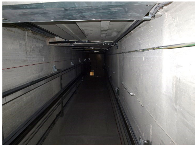
Abbildung 4: Aufzug eines MFH im Servicemodus, RWA am oberen Ende des Aufzugsschachtes geöffnet.
