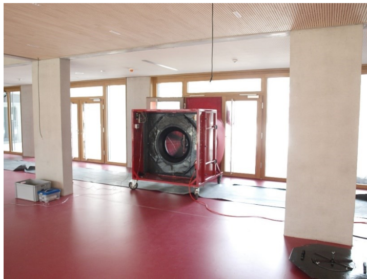
Abbildung 2: Messaufbau innen für Unterdruck am Gebäude einer Schule mit unserem Großventilator EC-LME (Leistung entspricht mehr als 5 tragbaren BlowerDoor-Ventilatoren) ...
