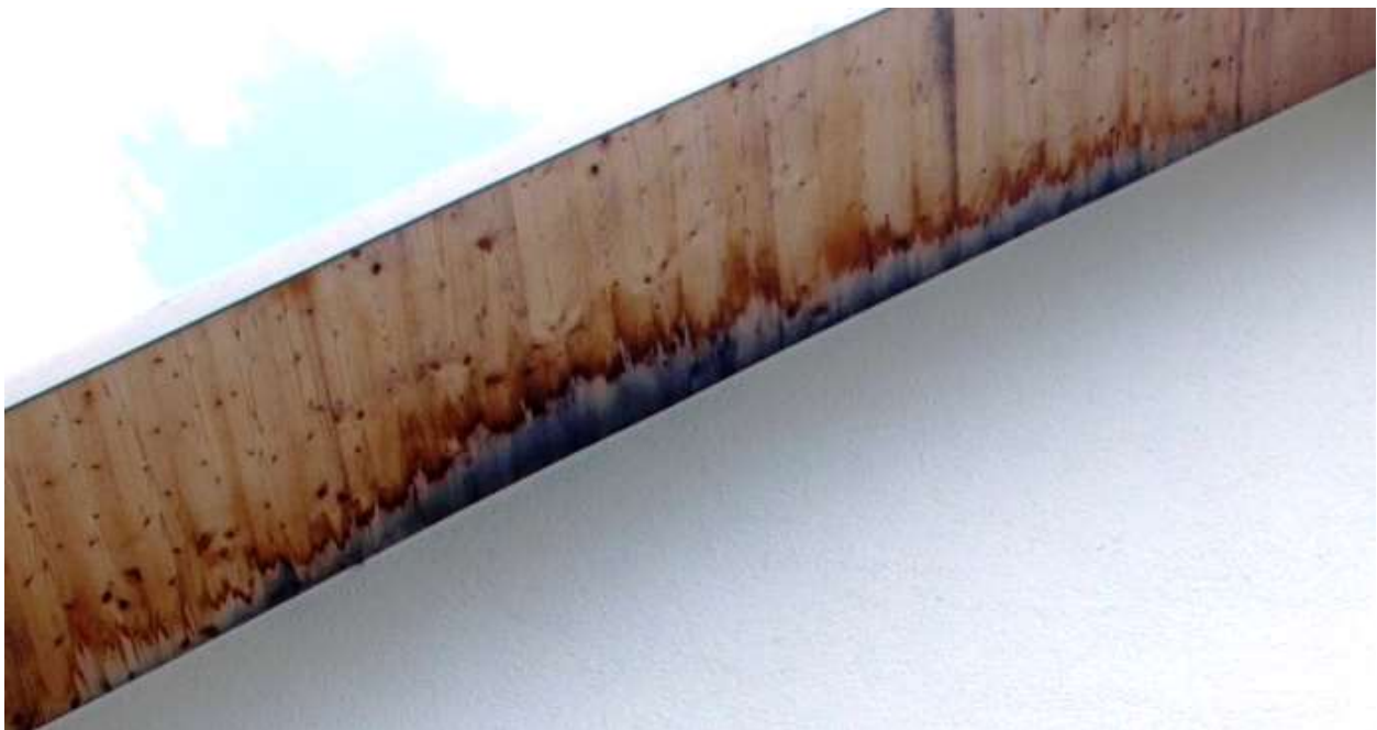
Abbildung 1: Furnierholzplatte am Dachrand wurde bei kaltem Winterwetter sichtbar feucht und dunkel.
