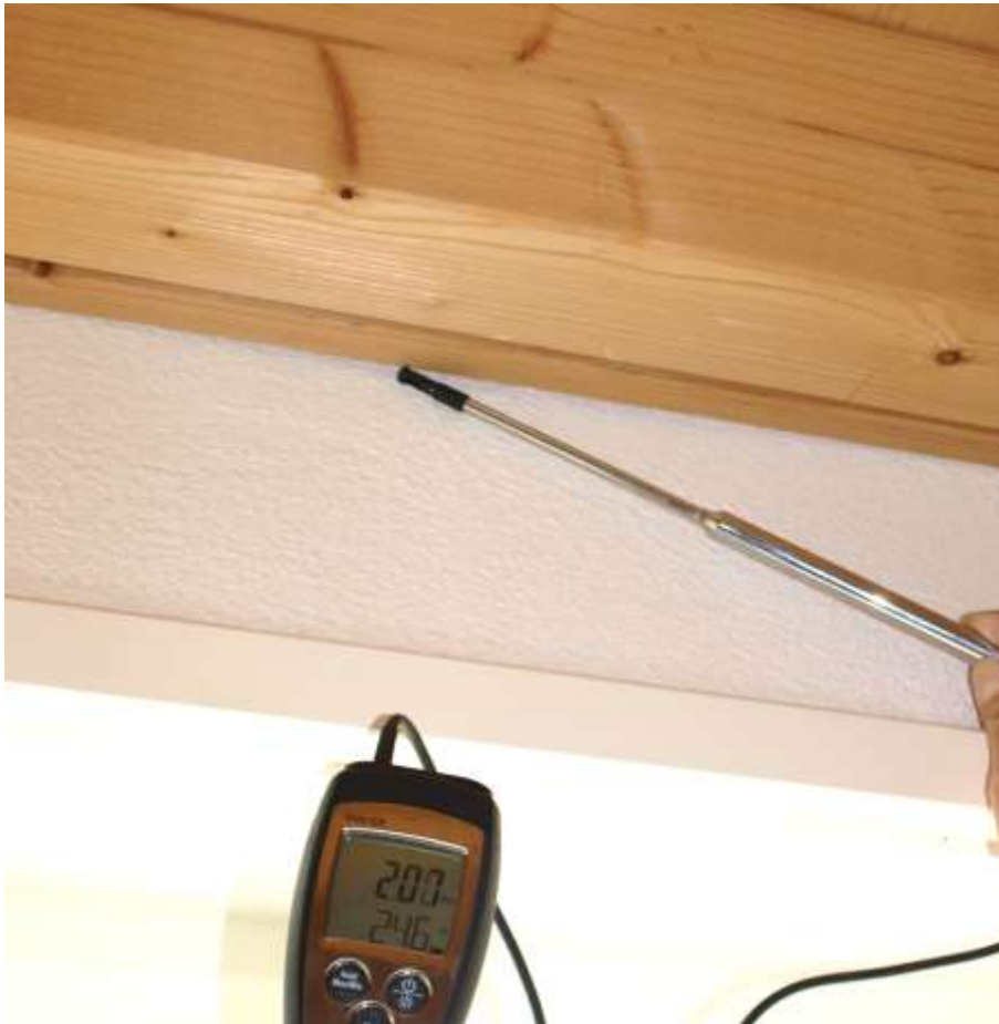
Abbildung 2: Deutliche Luftleckagen zwischen dem Holzbalken der Galerie und der Außenwand.
